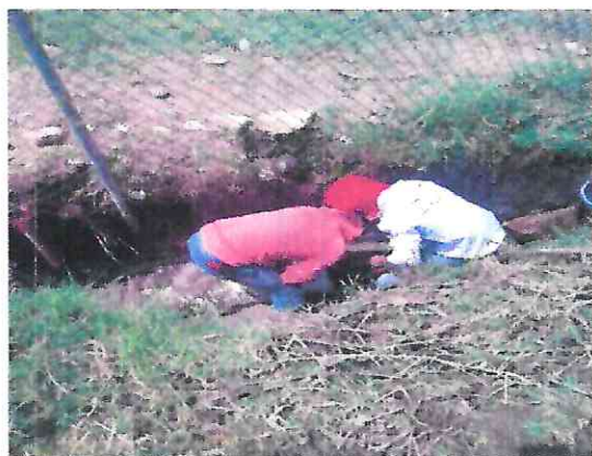
Pozo "Arroyo de los novios"
